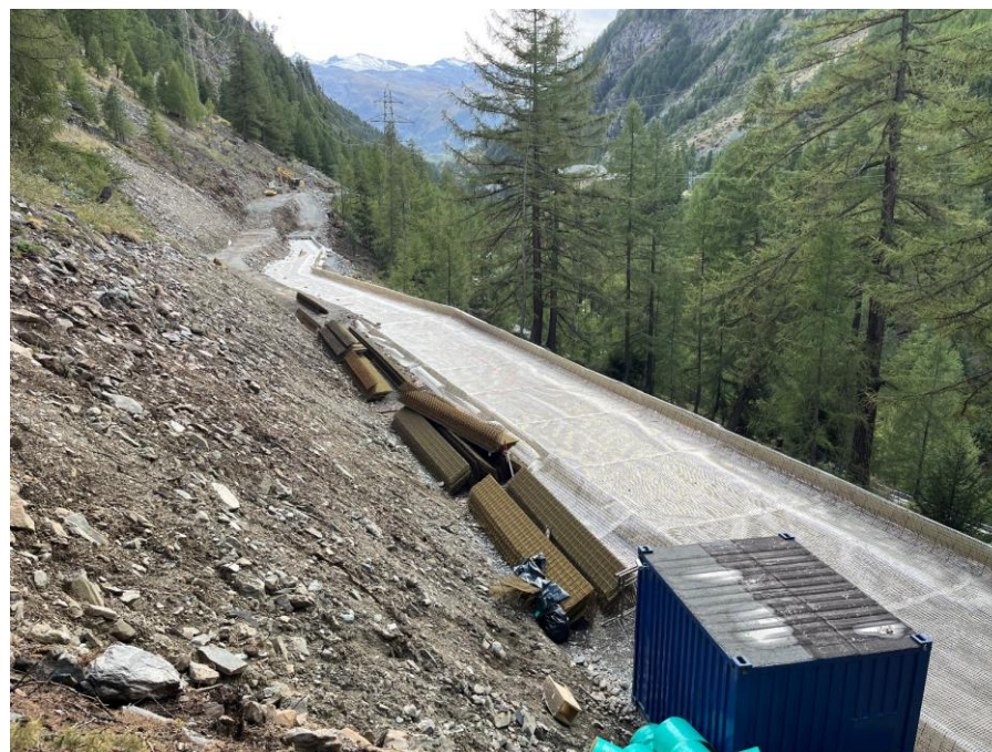
Mit Kunststoffgewebe bewährter Erddamm oberhalb der Kantonsstrasse
