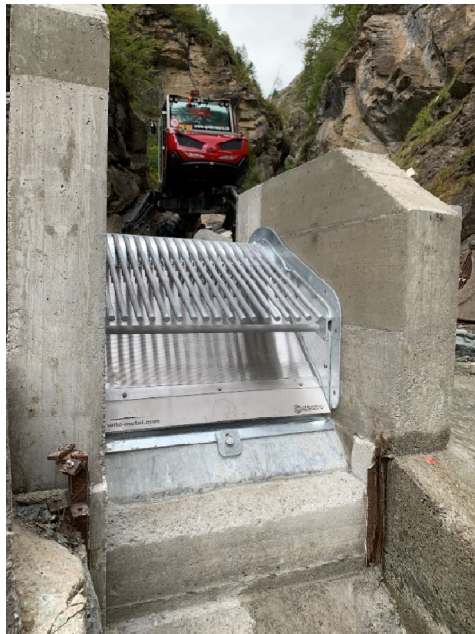
Foto vom 25. September 2021 (der neue Koanda-Rechen ist eingebaut)
