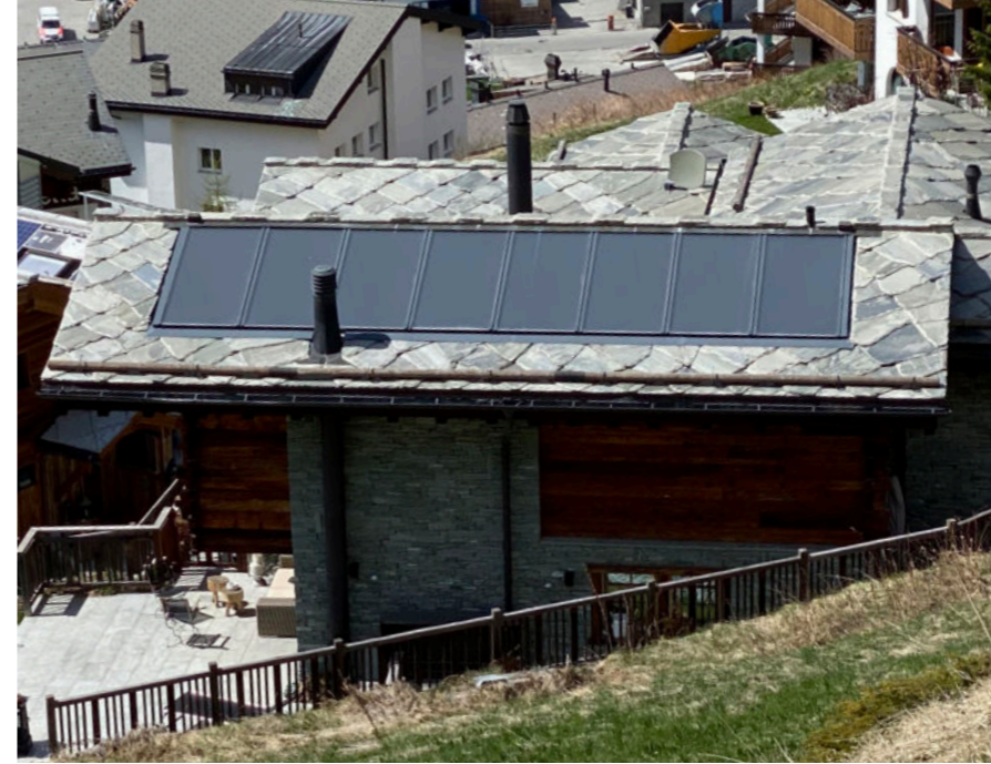
Solaranlagen auf dem Dach
